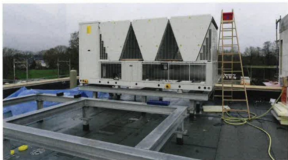
FGAC Kaltwassererzeuger mit R 454 B auf dem Dach montiert
