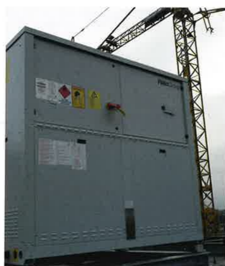
Anlieferung des FGAC Kaltwassererzeugers mit R 454 B
